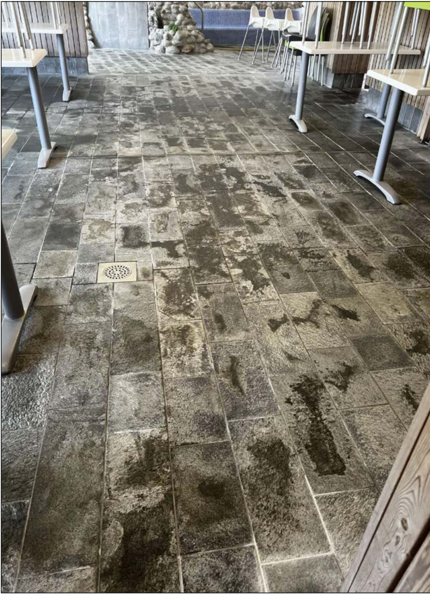
Feilbehandling Naturstein som er behandlet med feil type og for sterke renholdsmidler.
