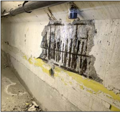
Figur 3 Korrosjon skjer sjelden på bassengets innside, men i teknisk rom kan lekkasjer fra fuger og gjennomføringer medføre betongskader.
