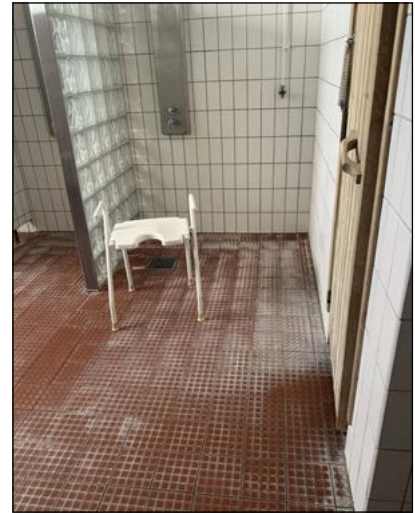
Lyst til å dusje? Kalkbelegg som har bygget seg opp.
